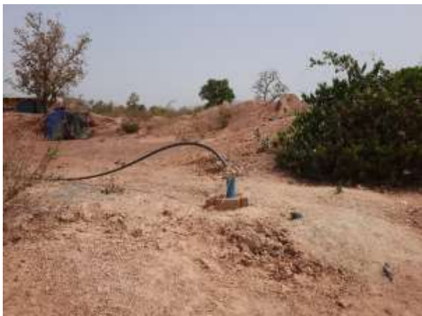
Photo 5 : Pompe pour l'exhaure des eaux souterraines sur un site d'orpaillage de Tabakoto
